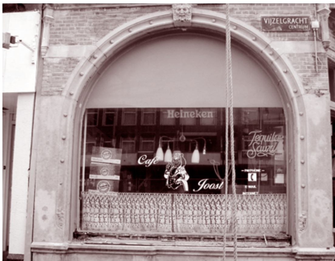
Vijzelgracht 63: na het herstel van het natuursteen wacht de onderdorpel nog op herstel
