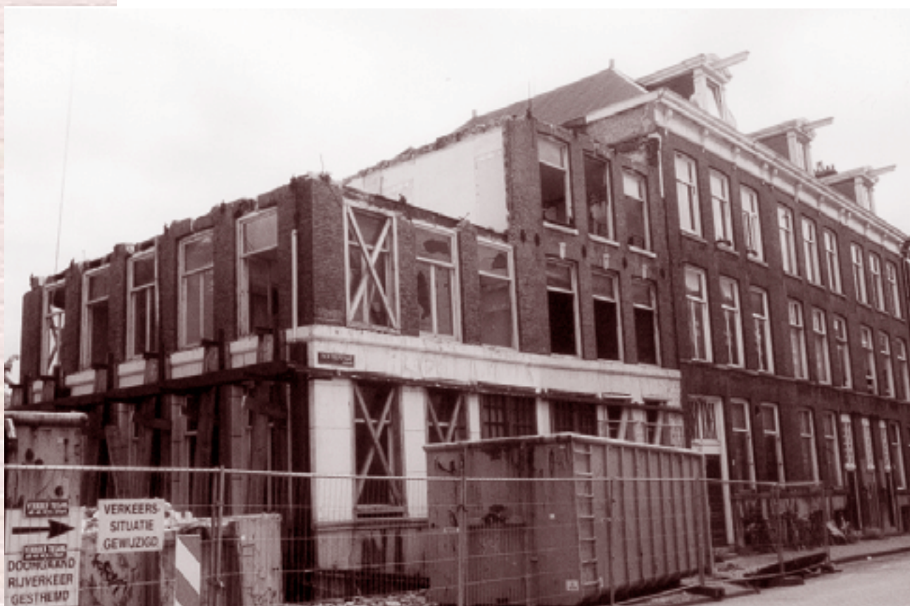
Troosteloze aanblik van verzakkende bebouwing Prof. Tulpstraat
